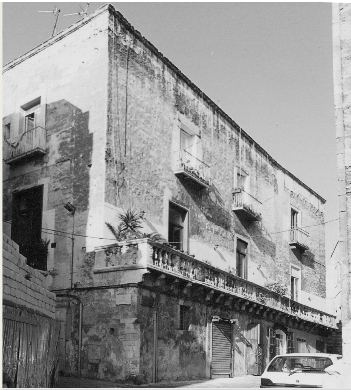
Palazzo Zeuli prima del consolidamento (foto dell'ing. Gregorio Pizzutilo, direttore dei lavori)
