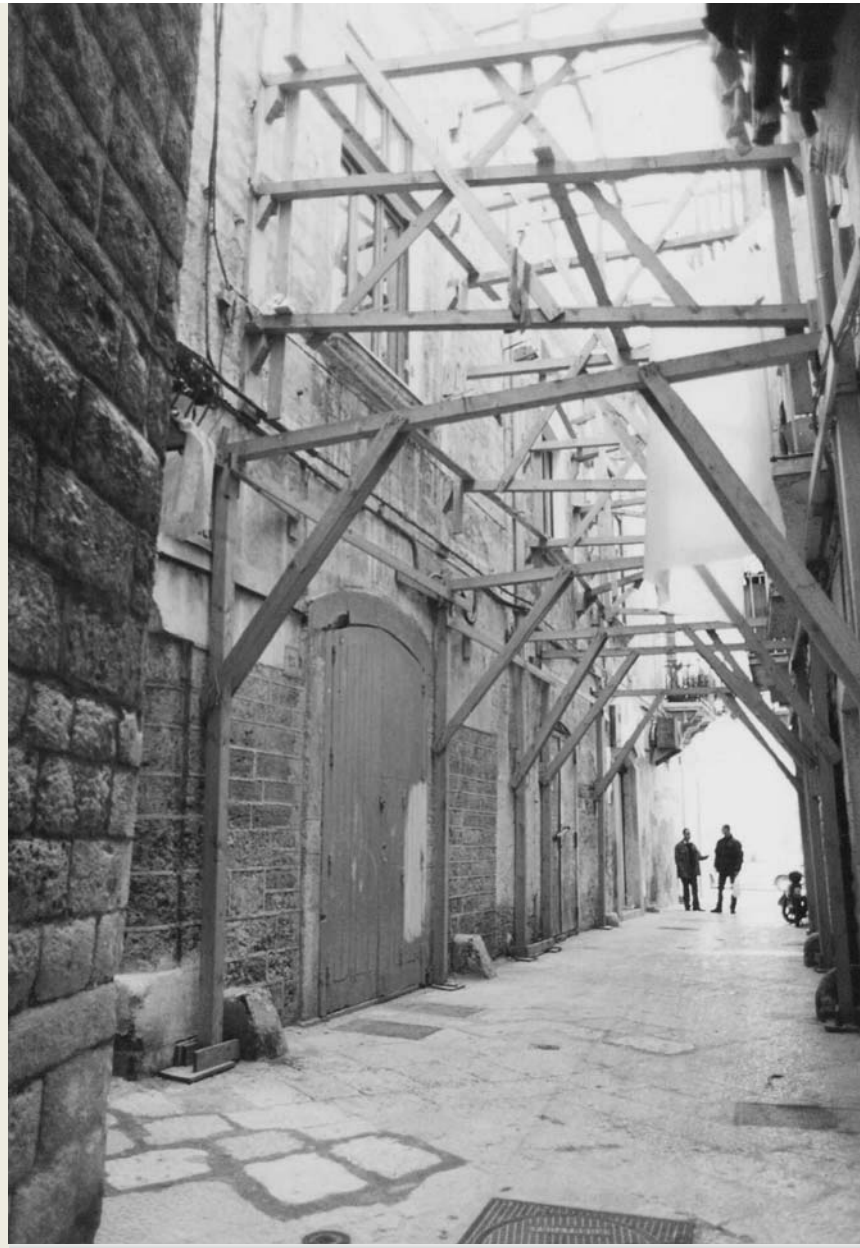
Palazzo Zeuli prima del consolidamento (foto dell'ing. Gregorio Pizzutilo, direttore dei lavori)
