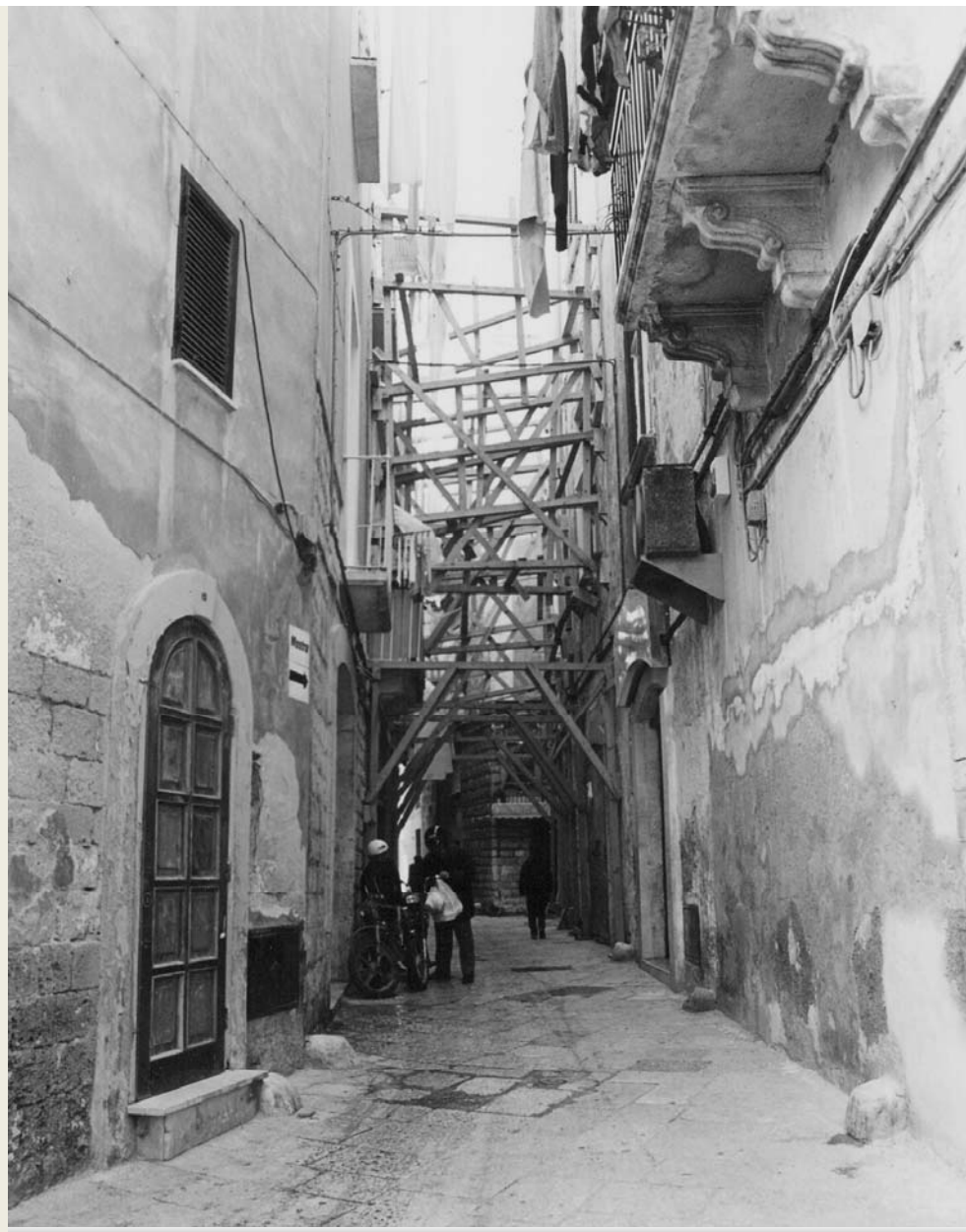
Palazzo Zeuli prima del consolidamento (foto dell'ing. Gregorio Pizzutilo, direttore dei lavori)
